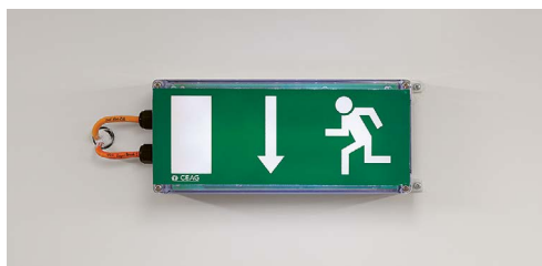
4 Illuminazione d'emergenza (elettrica)
